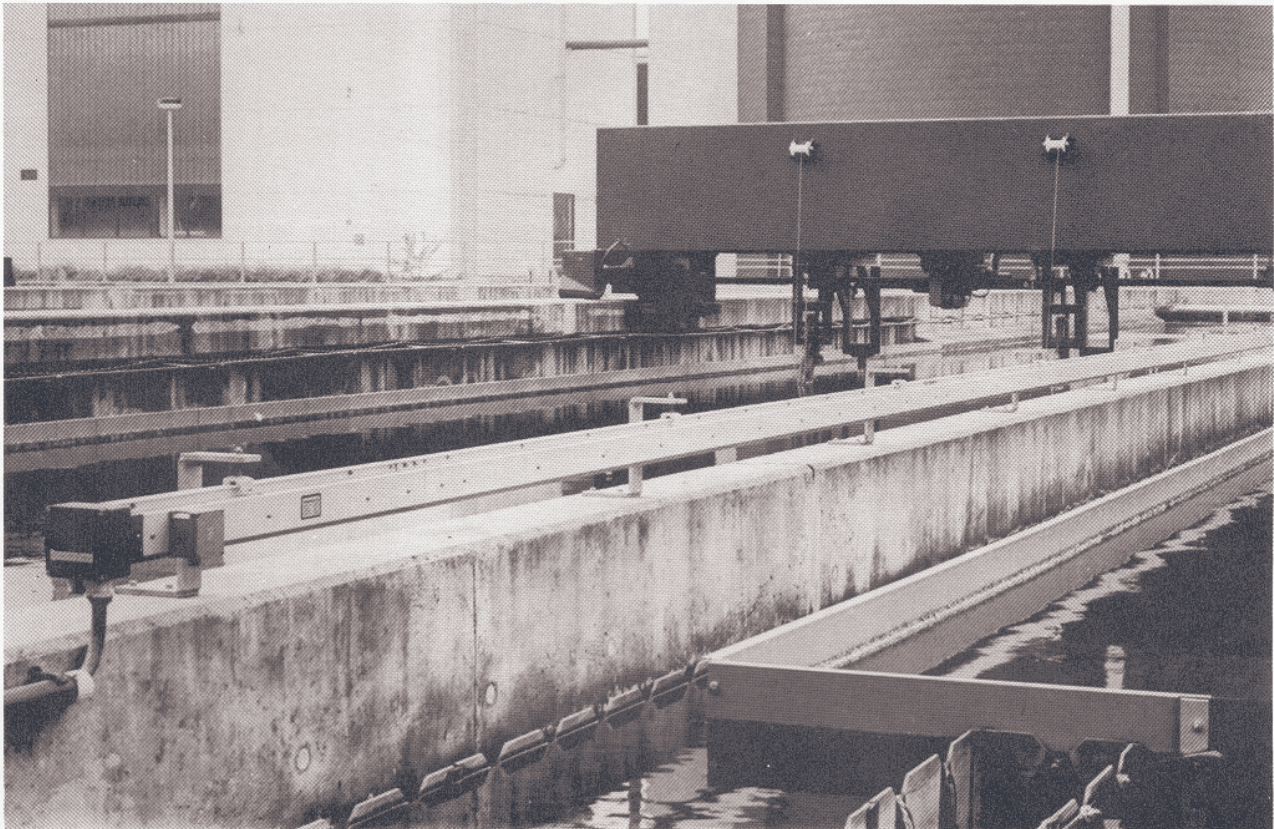
Sicherheits-Schleifleitung LSV mit Beheizung an einer Kläranlage
